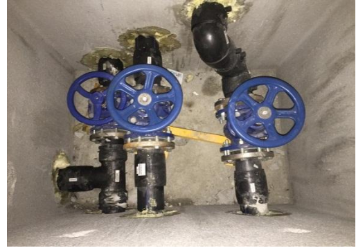
25 m3 Depo Vana Odası Sakarya Uygulaması
