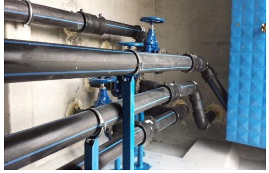
50 m3 Depo Vana Odası Sakarya Uygulaması
